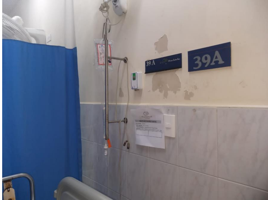
Figura 75. Timbre desconectado, timbre que no funciona, ronda de seguridad hospitalización bloque B, sede principal.
