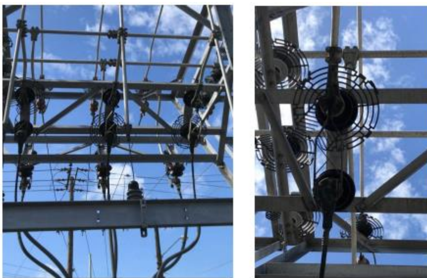
Figura 26. Dispositivos electrostáticos colocados sobre los aisladores de porcelana de los soportes de las cuchillas en una subestación, diseño y forma correcta de colocar.
