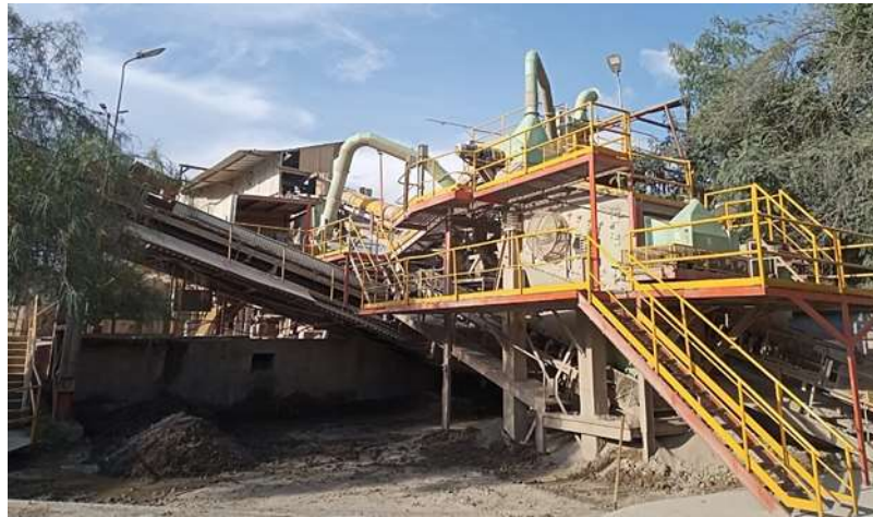
Figura 7. Trituradora de la planta
