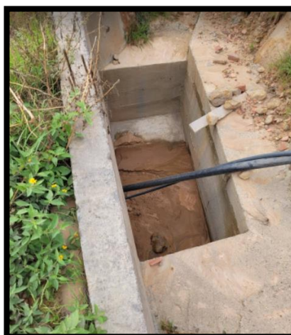
Ilustración 23. Estado de las tanquillas del título 374, tomada al área de estudio, 2022.
