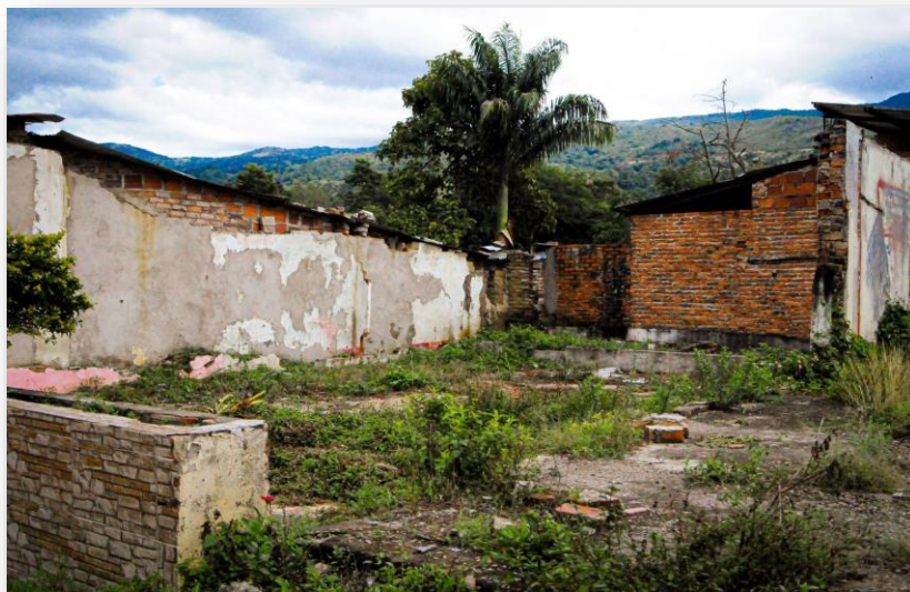
Casa afectada por el desastre natural
