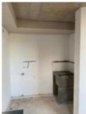
Foto 16. Zona de ropas apto tipo A pendiente por resane y sin Silcoplast en placa
