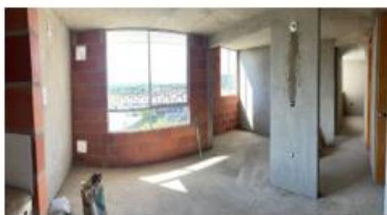
Foto 29. Zona sala comedor, falta detalles en obra gris apto tipo C
