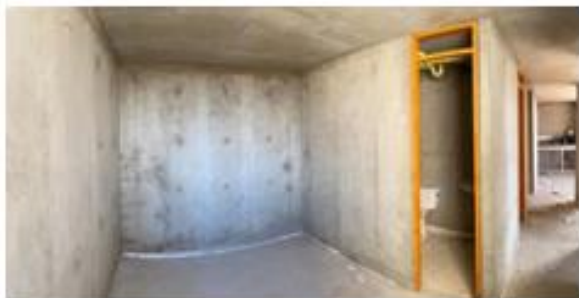
Foto 4. Habitación principal falta de pulir concreto
