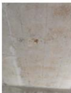
Foto 21. Se retiró y corrigió el detalle en placa de apto 501
