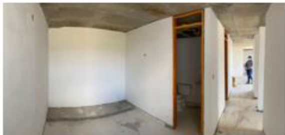
Foto 10. Apto tipo A con instalación de puertas en los baños sin Dry Wall
