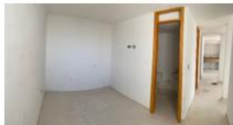
Foto 25. Hab. Principal y pasillo apto tipo C, falta detalles semiacabados
