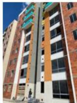
Foto 70. Fachada torre 3 falta parte de carpintería metálica
