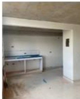
Foto 13. Zona comedor cocina con Dry Wall instalado y sin silcoplast en placa apto tipo
