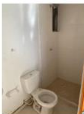
Foto 18. Baño principal sin resane en guarda escobas
