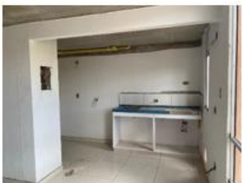
Foto 47. Zona cocina apto tipo A sin Dry Wall y cableado a la vista
