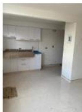
Foto 20. Cocina apto tipo A con instalación de carpintería de madera y falta resane en guarda escobas
