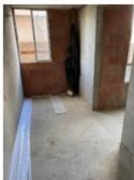
Foto 1. Alcoba auxiliar 2, sin muro divisorio en obra negra
