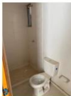
Foto 21. Baño social falta adecuar guarda escobas
