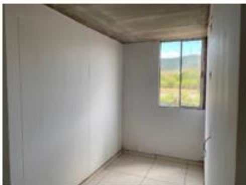
Foto 46. Hab. Auxiliar 2, muro divisorio y con cableado a la vista
