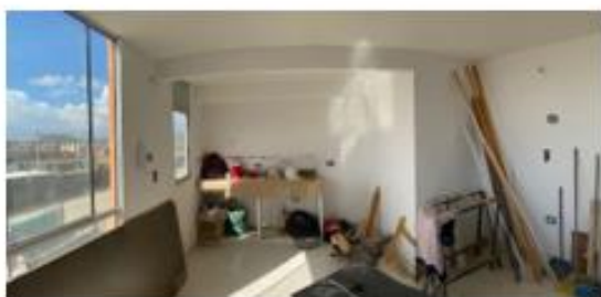
Foto 24. Cocina comedor apto tipo B, falta detalles
