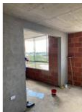
Foto 59. Espacio de hab. Auxiliar 2 terminada en obra gris apto tipo C 604 Torre 1
