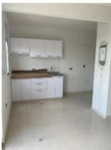
Foto 30. Cocina de apto tipo A con detalles de resane pendientes
