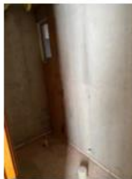
Foto 49. Zona de baño con tubería sanitaria y sin instalación de accesorios
