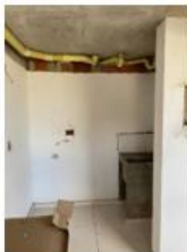
Foto 43. Zona de ropas tipo A sin resanes y sin Dry Wall
