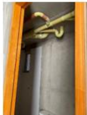
Foto 7. Baño hab. Principal con accesorios en obra gris y tubería a la vista
