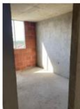
Foto 27. Hab. Auxiliar 1 falta detalles en obra gris
