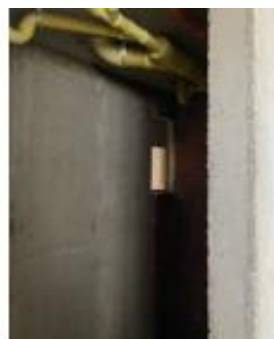
Foto 4. Baño social sin accesorios, tubería a la vista
