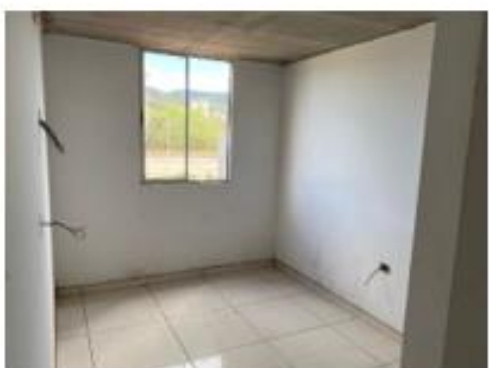
Foto 48. Hab. Auxiliar 1 con cableado a la vista
