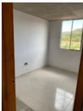
Foto 56. Hab. Auxiliar 1 pendiente por instalación de closet
