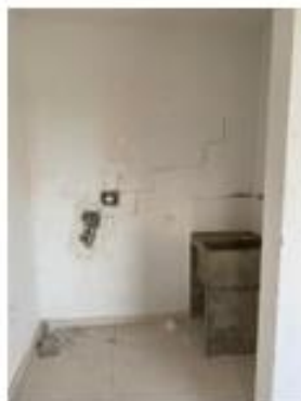
Foto 34. Zona de ropas de apto tipo A con detalles de resane pendientes
