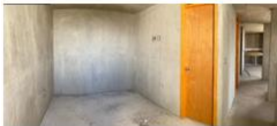
Foto 28. Hab. Principal falta detalles en obra gris apto tipo C
