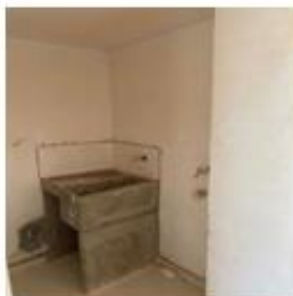
Foto 31. Zona de ropas de apto tipo C con detalles de resane pendientes
