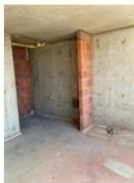
Foto 54. Zona de cocina apto tipo C sin instalación de base y mesón
