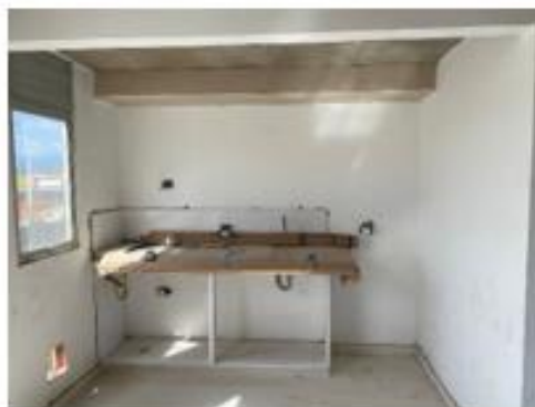
Foto 58. Zona cocina apto tipo B, sin silcoplast y pendiente de instalación rejilla ventilación
