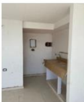
Foto 32. Zona de cocina de apto tipo C con detalles de resane pendientes
