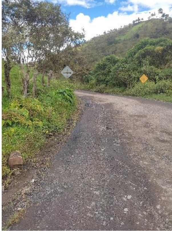
Figura 13. Superficie de rodadura sin cuneta.
