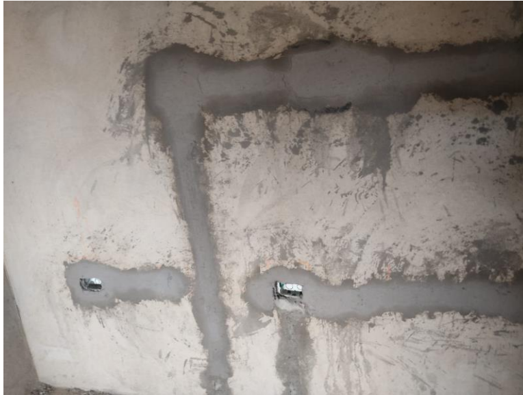
Imagen 75. Resane Regatas en Muro con Pañete. Tomada en Obra, Elaboración Propia. CEIMLAB.
