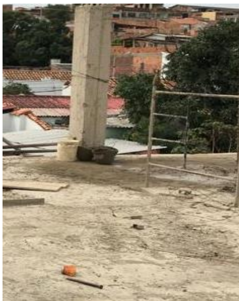
Imagen 14. Inicio del Vaciado del Concreto de 3600P.S.I. Tomada en Obra, Elaboración Propia. CEIMLAB.
