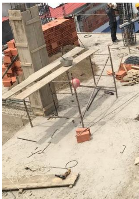
Imagen 11. Inicio de Encofrado de las Columnas C1 y C2. Tomada en Obra, Elaboración Propia. CEIMLAB.
