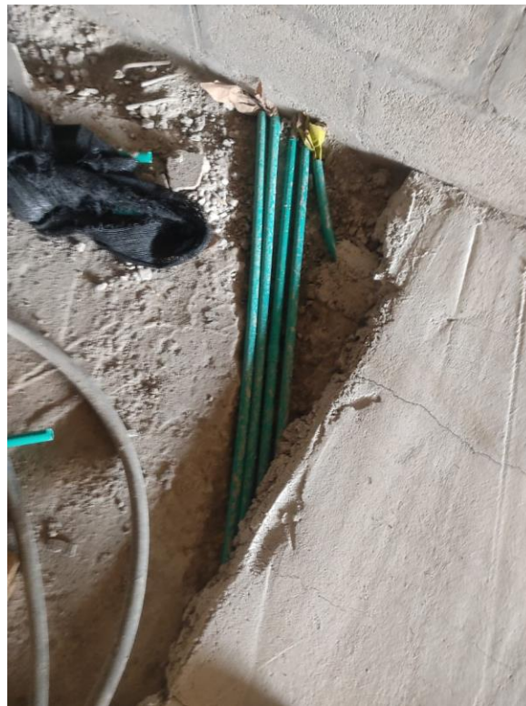
Imagen 76. Tubos en Placa. Tomada en Obra, Elaboración Propia. CEIMLAB.
