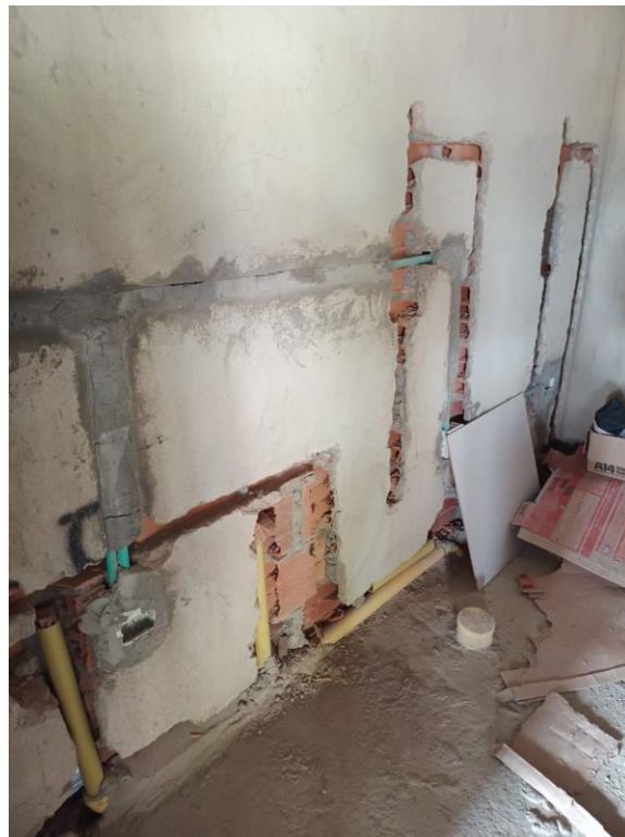
Imagen 74. Instalación Hidráulica y Sanitaria. Tomada en Obra, Elaboración Propia. CEIMLAB.
