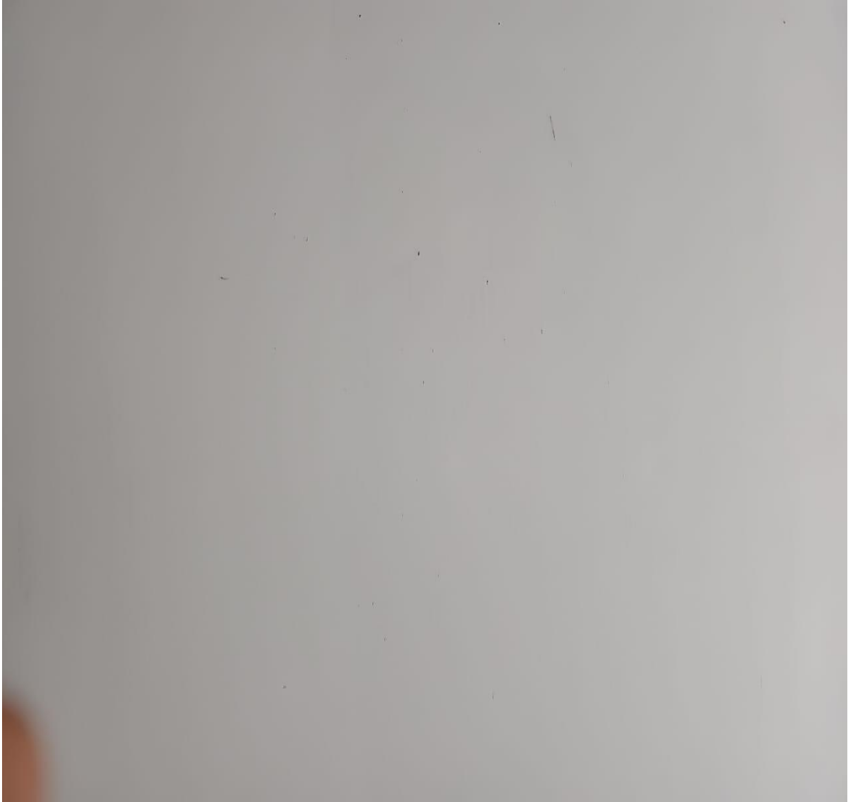
Imagen 78. Muros Estucados sin Pintura. Tomada en Obra, Elaboración Propia. CEIMLAB.
