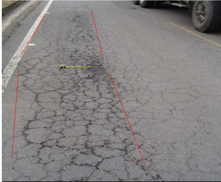
Figura 10. Patología Piel de Cocodrilo.
