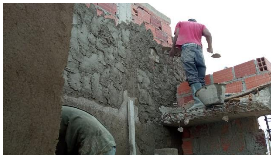
Figura 50 Pañete casa 10 Mz B
