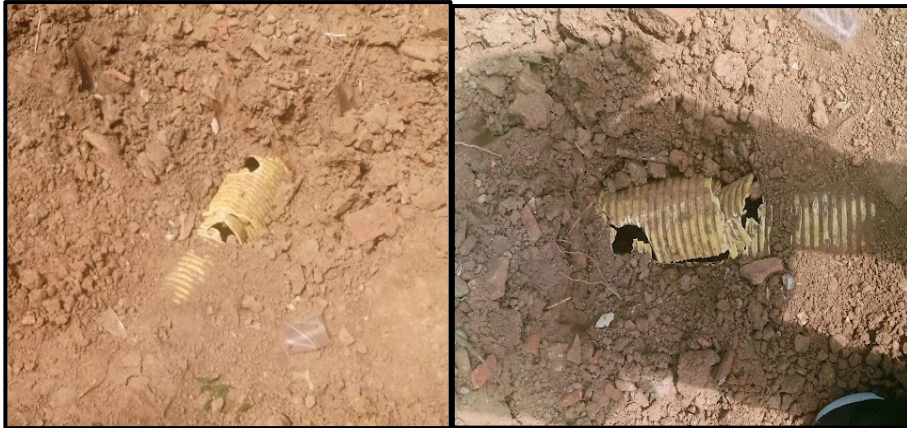
Ilustración 19. Afectación de tubería de PVC de 6”
