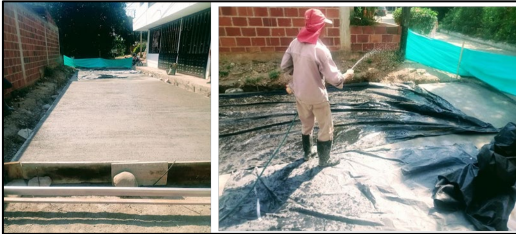
Ilustración 22. Instalación de concreto del K0+000 al K0+015, y se suministra agua para el curado del concreto.
