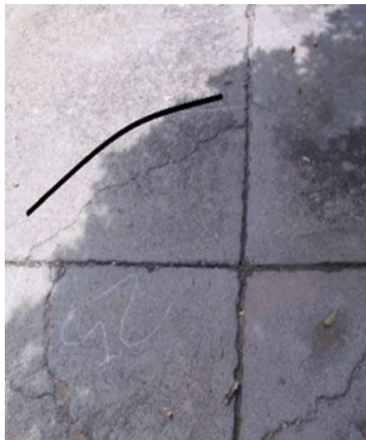
Figura 9. Grieta de esquina sub-segmento 2
