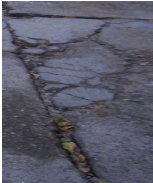
Figura 6. Grieta en bloque sub-segmento 1
