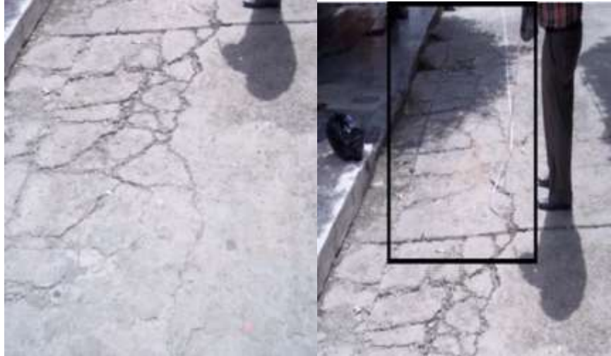
Figura 8. Grietas en bloque sub-segmento 2
