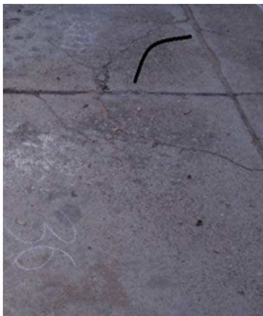
Figura 11. Grieta de esquina sub-segmento 3
