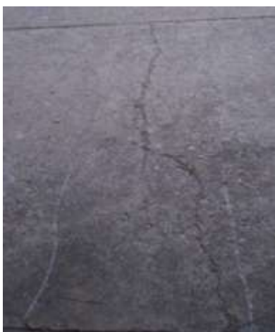
Figura 4. Fisuras longitudinales sub-segmento 1
