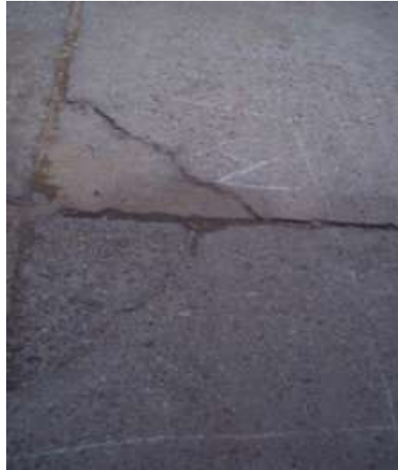
Figura 5. Grieta de esquina sub-segmento 1
