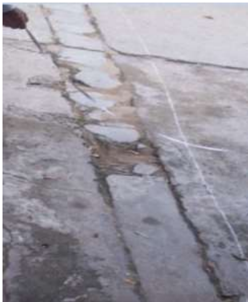
Figura 7. Daños por intervención de servicios públicos
