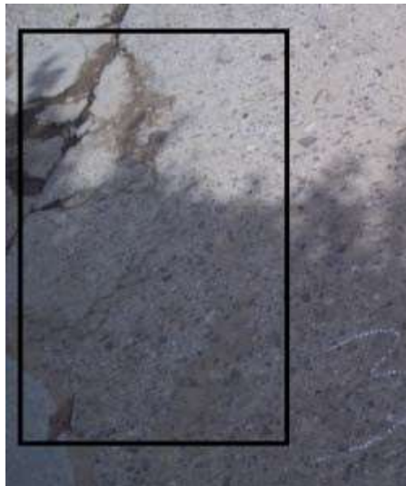
Figura 16. Grieta en bloque sub-segmento 5
