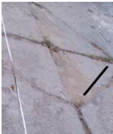
Figura 12. Grietas de esquina sub-segmento 3
