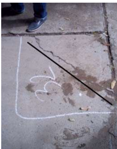
Figura 17. Grieta esquina sub-segmento 6
