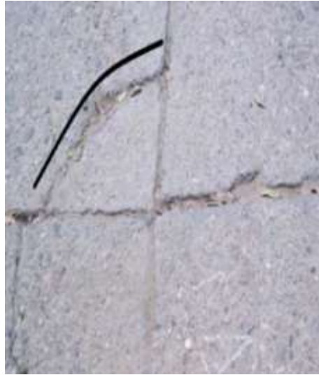
Figura 13. Grieta de esquina sub-segmento 4
