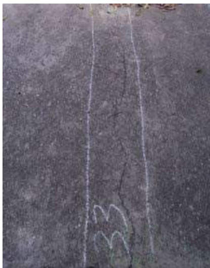
Figura 18. Grieta transversal sub-segmento 6
