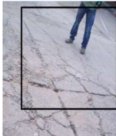
Figura 14. Grieta en bloque sub-segmento 4
