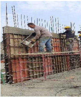
Figura 51. Desenfoque de los muros estructurales, segundo piso
