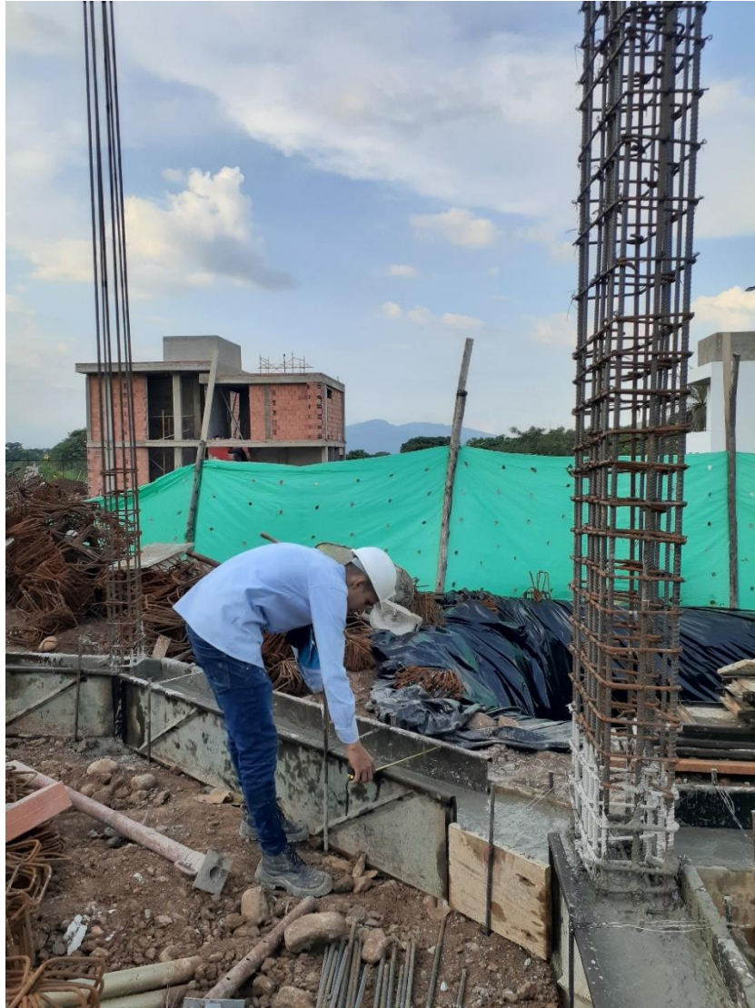
Figura 28. Evaluación de recubrimiento en vigas de cimentación.
