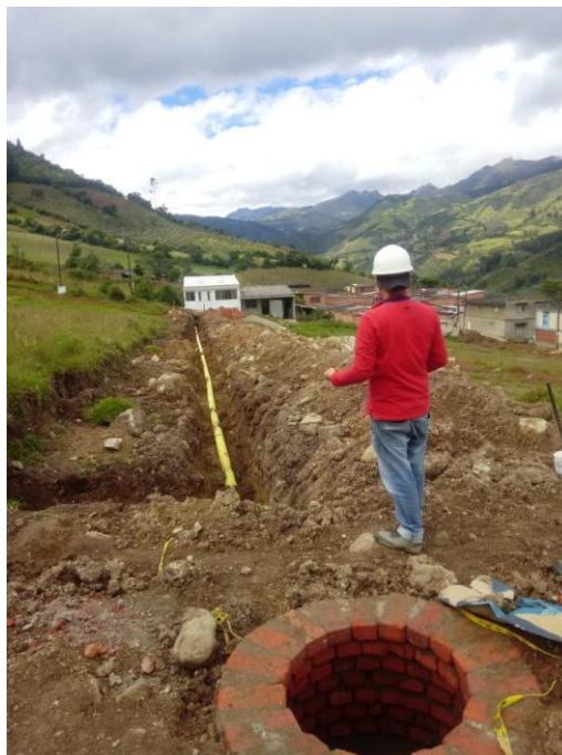
Figura 7. Tramo de Tubería PVC sanitaria de 8" entre pozos de Inspección
