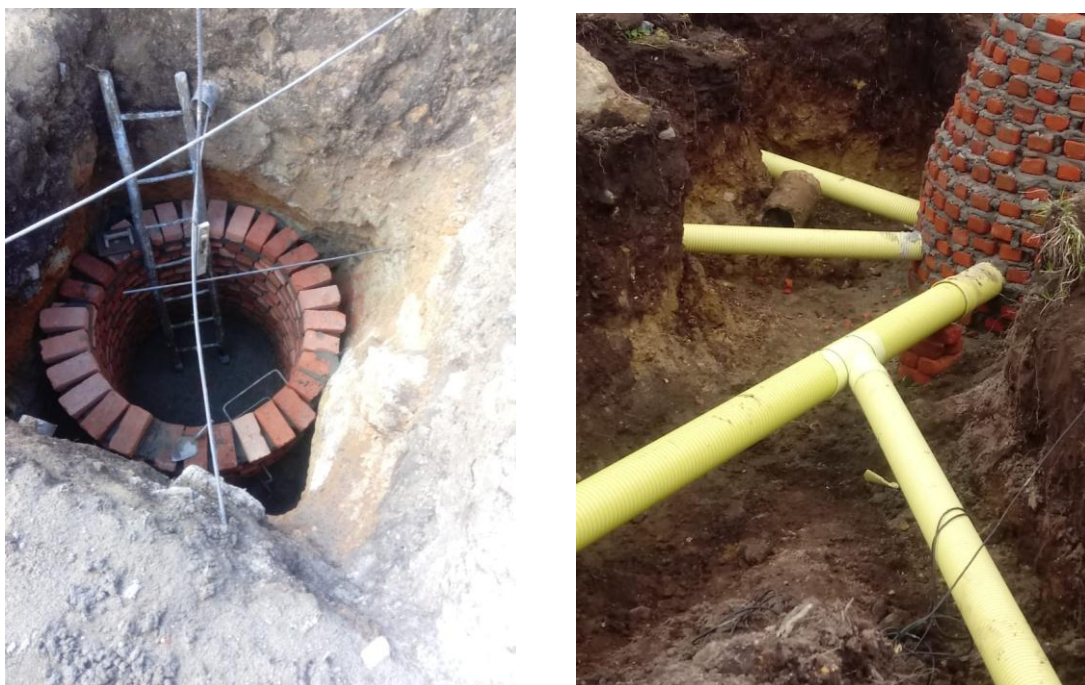
Figura 9. Mampostería y conexiones de un Pozo de Inspección
