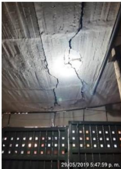
Figura 48. Vista frontal daños en muros y placa de terraza
