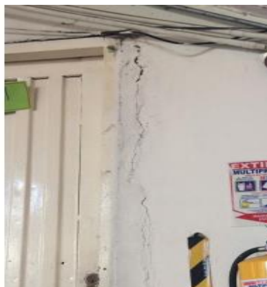
Figura 26. Grieta existente en los muros
