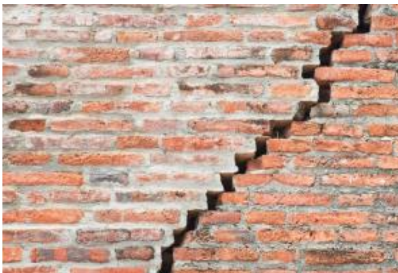
Figura 24. Agrietamiento presentando debido a fallas geológicas, con presencia de moho
