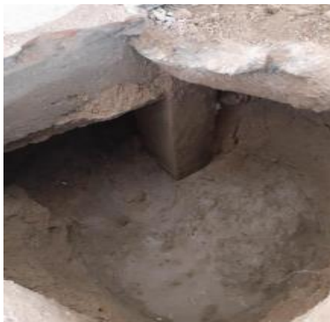
Figura 39. Ausencia de zapata bajo columna
