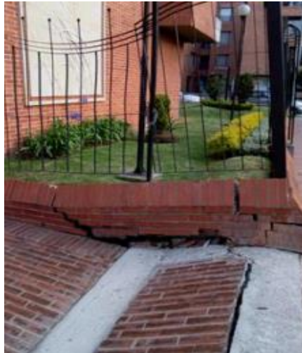
Figura 43. Daños en el acceso al edificio abril del 2019
