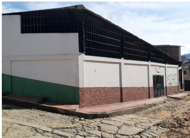
Figura 41. Anden y calles con presencia de hundimientos
