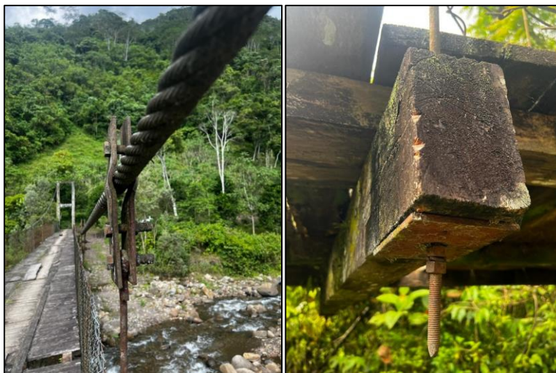
Figura 7. Ejemplo de corrosión en elementos metálicos
