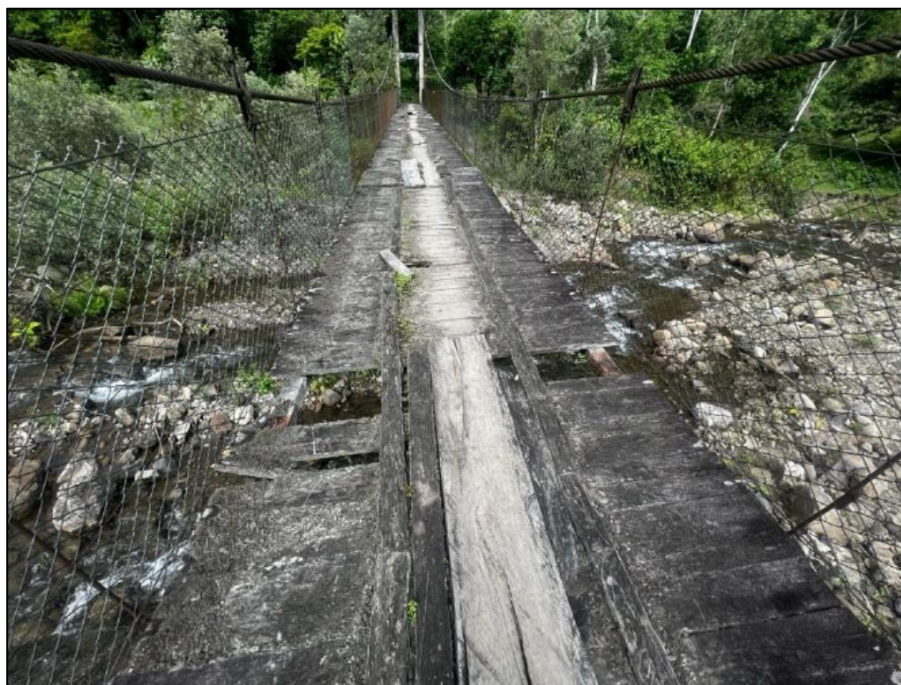
Figura 6. Ejemplo de patologías físicas
