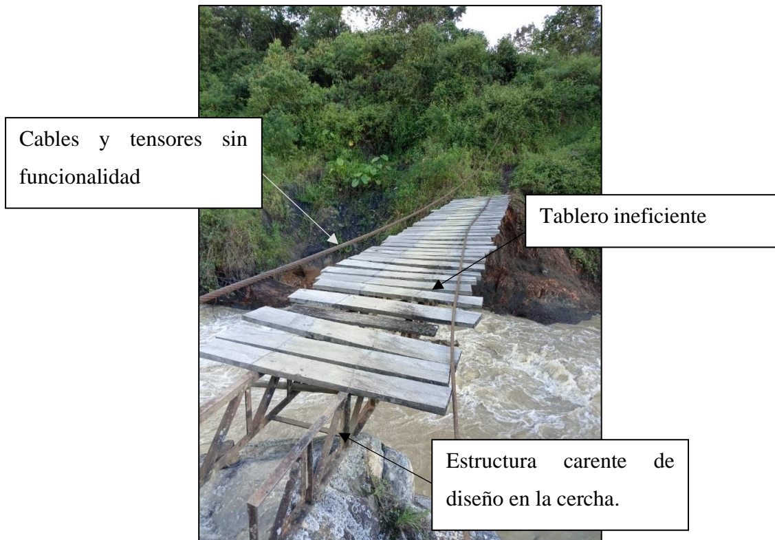
Figura 10. Ejemplo de patologías debidas al proyecto
