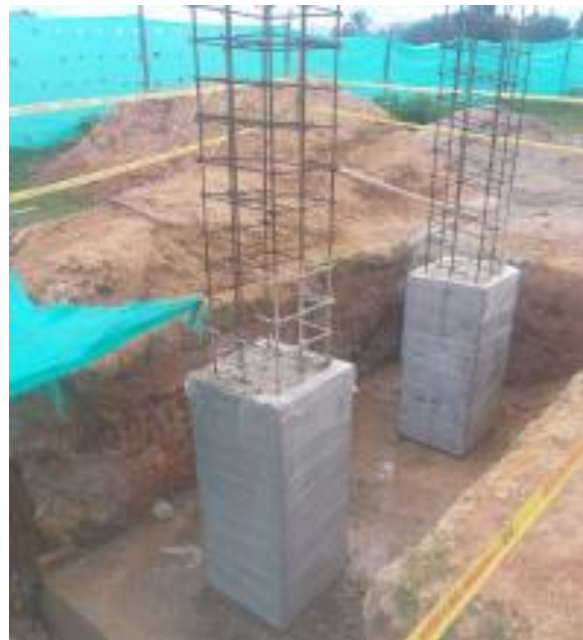
Imagen 14: Pedestales en concreto
