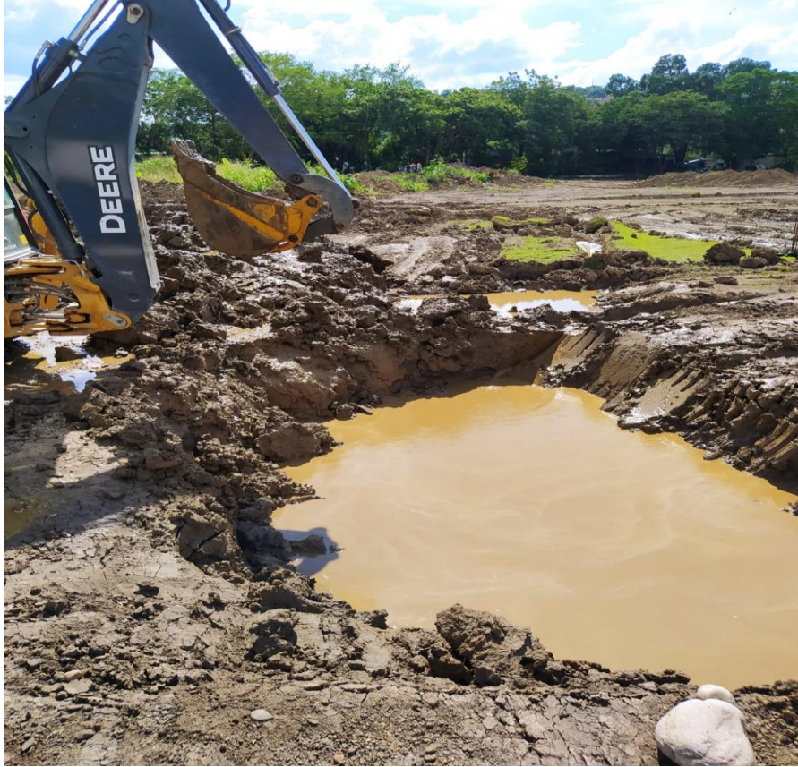
Figura 5. Localización de fallos. Construcción de la obra madeira, ciudad de Cúcuta
