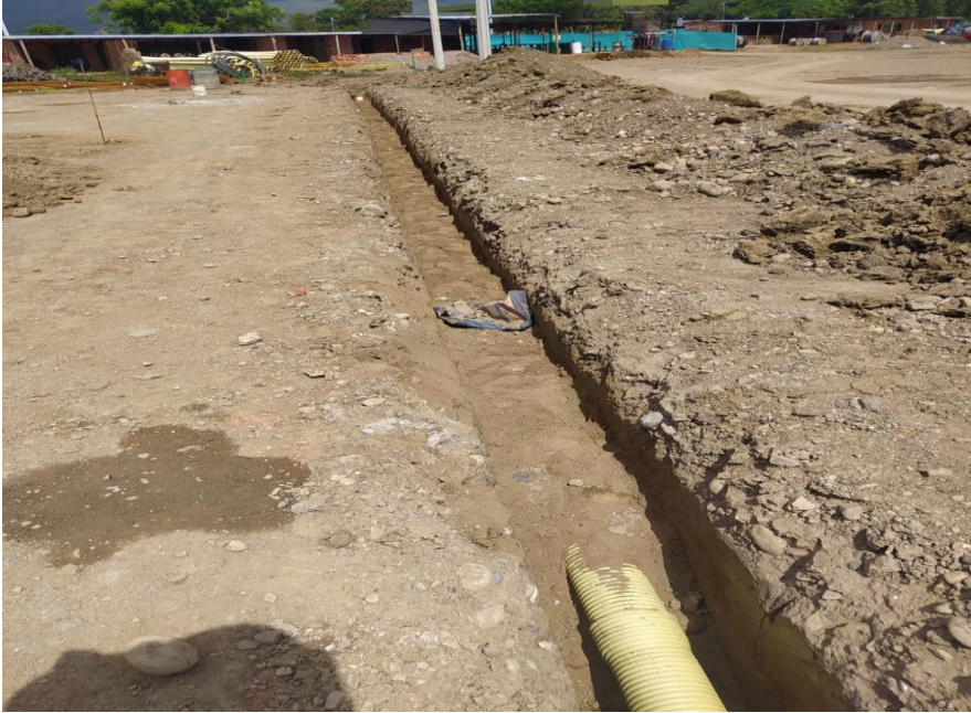
Figura 24. Relleno del alcantarillado principal. Construcción de la obra madeira, ciudad de Cúcuta.
