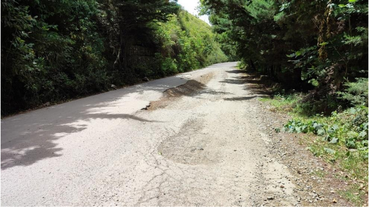
Figura 5. Fallas sobre la superficie de rodadura.
