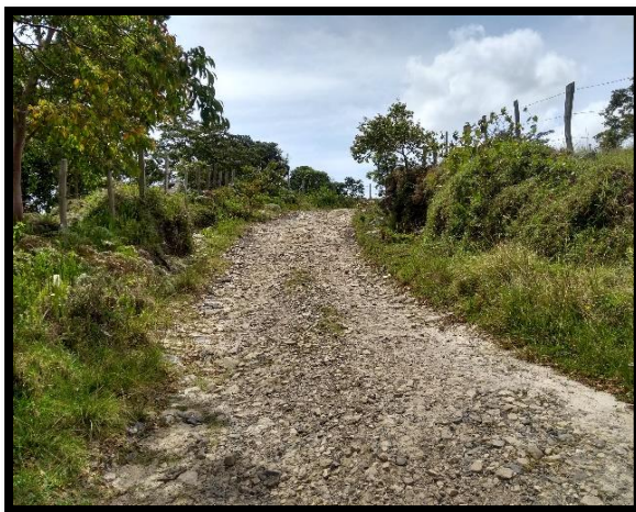
Figura 6. Tramo3 afectado a intervenir. Superficie de rodadura. “sector garza- zumbador”
