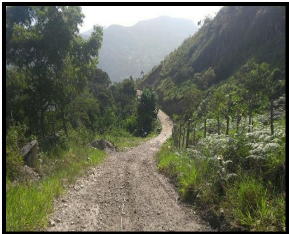
Figura 5. Tramo2 afectado a intervenir. Superficie de rodadura. “sector zarzales-san isidro”
