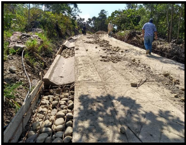
Figura 34. Se procedió a colocar el acero de refuerzo y la piedra rajón
