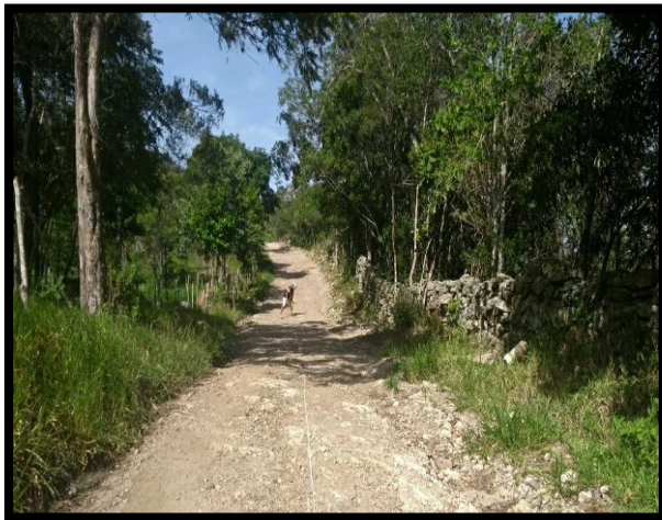
Figura 4. Tramo1.afectado a intervenir. Superficie de rodadura “sector Reforma-Pomarroso”
