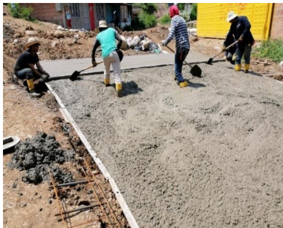
Figura 28. Cuando el laboratorista da el visto bueno, se procede a instalar las formaleas para el posterior vaciado del concreto
