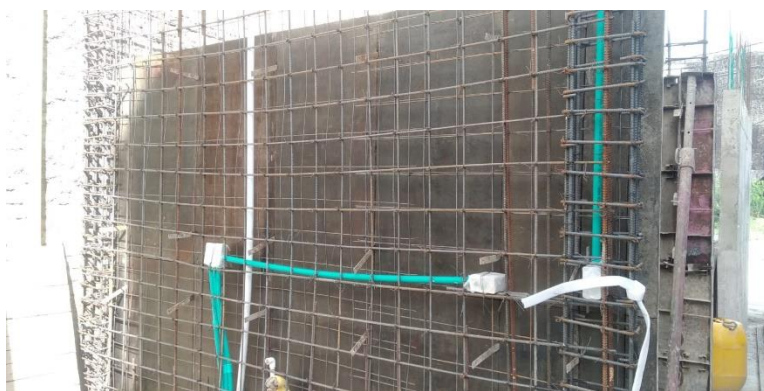
Figura 12. Muro con sus puntos eléctricos
