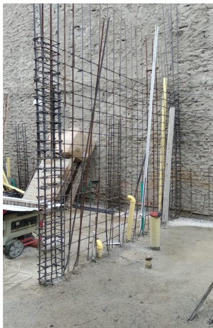
Figura 11. Muro con sus puntos hidráulicos y sanitarios
