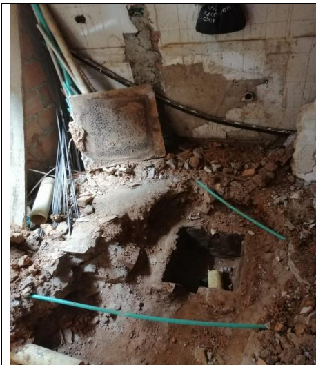
Caja de inspeccion interna
