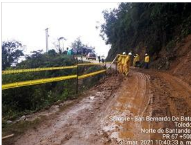
Figura 16. Actividad señalización con pérdida de banca. Fuente: COOTRASCUB
