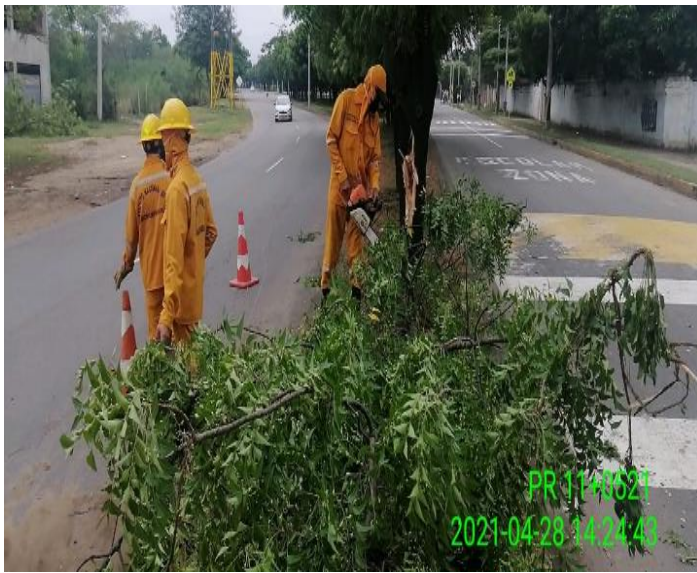
Figura 13. Emergencia vía 55NSA, calzada derecha
