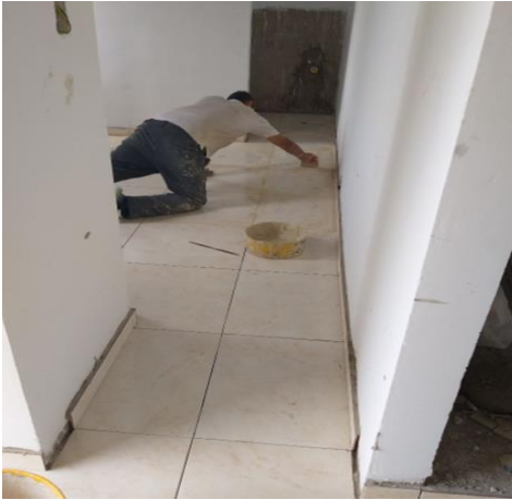
Figura 14. Brehado de piso
