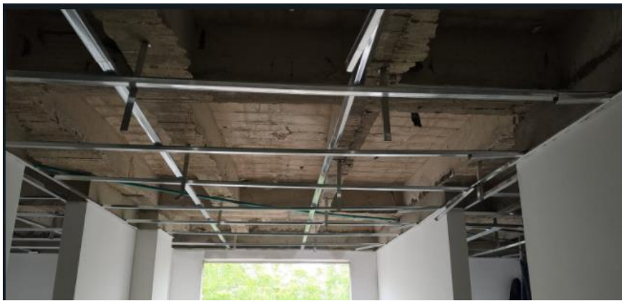
Figura 35. Estructura de Drywall
