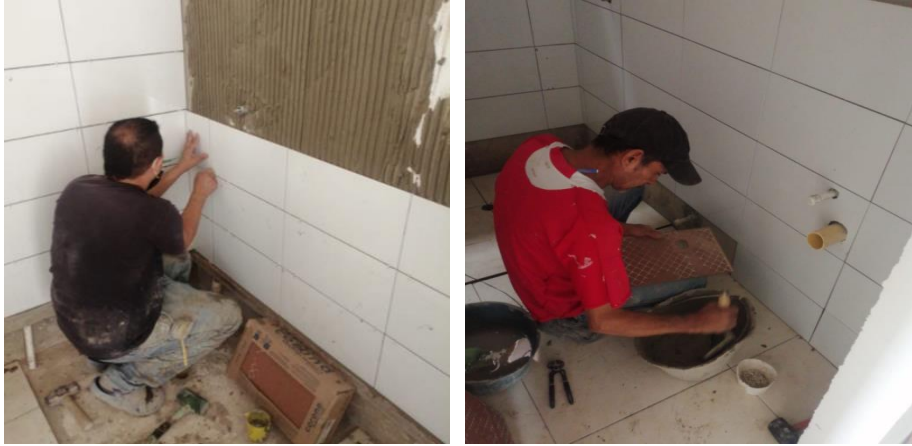
Figura 16. Enchape en muros de baños
