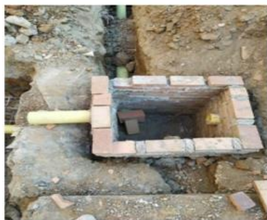
Caja de inspeccion.
