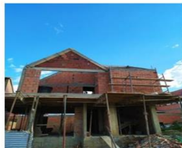
Viga corona fundida.
