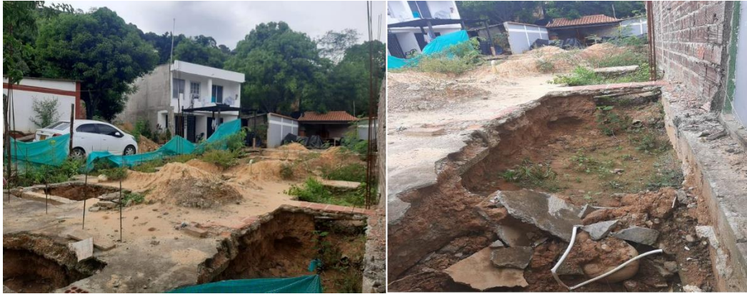
Figura 33. Evidencia de obra nueva con unas excavaciones de zapatas, erosionadas por las lluvias
