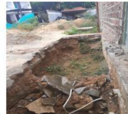
Ilustración 2. Se observa excavaciones de zapatas erosionadas por las continuas lluvias
