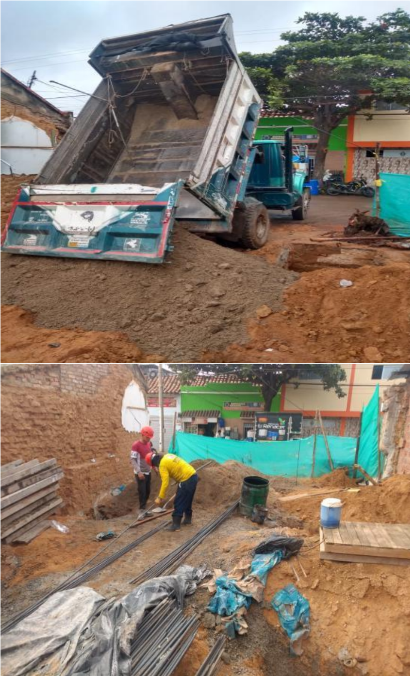
Figura 15. Descargue de material para construcción de la edificación y llegada de varillas para el armado de las vigas
