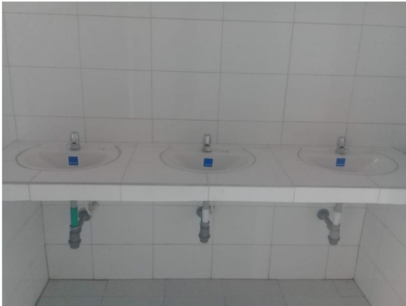
Figura 58. Mesón baterías sanitarias
