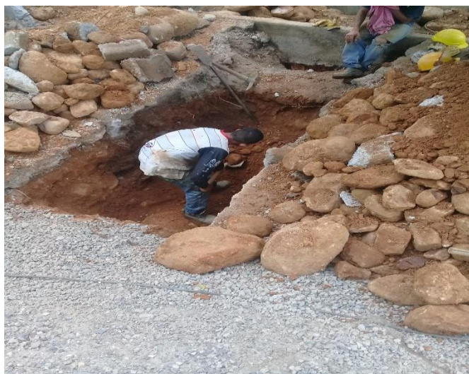
Figura 26. Excavación en tierra o material común y/o conglomerado a mano, incluye transporte interno (m3) (rampa)
