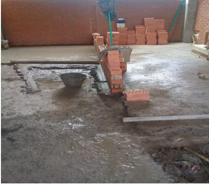
Figura 47. Ante piso baterías sanitarias
