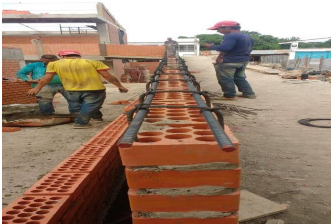
Figura 71. Viga sobre muro
