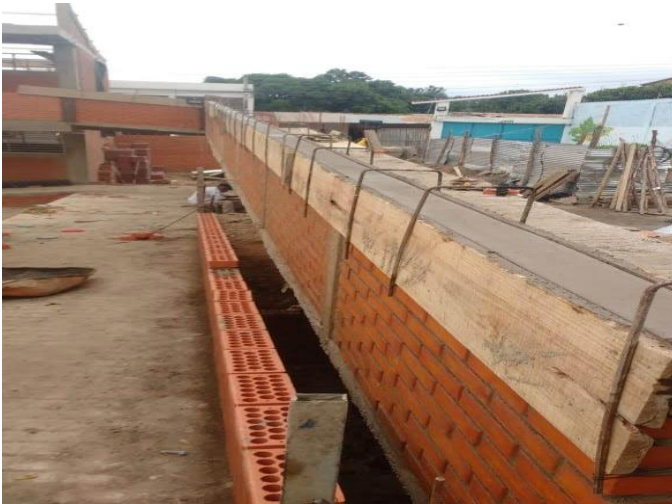
Figura 72. Viga sobre muro
