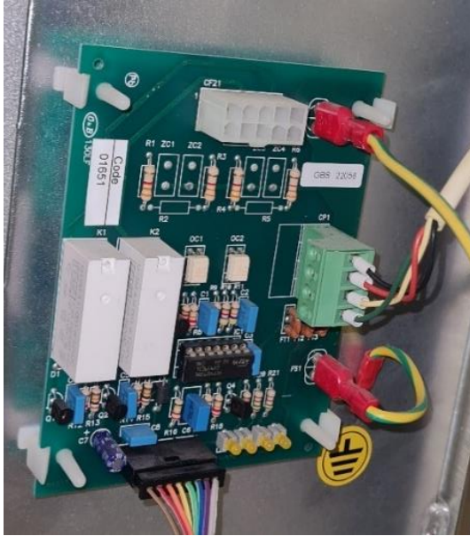
Figura 75. Tarjeta de regulación y control de disparo
