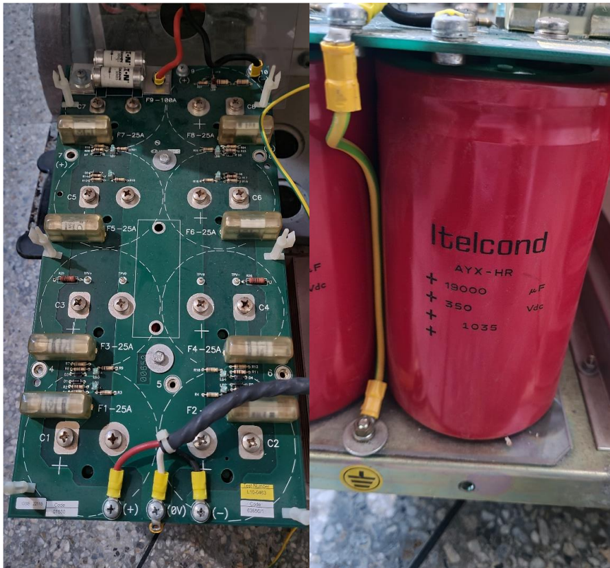
Figura 70. Tarjeta 01643 y capacitores
