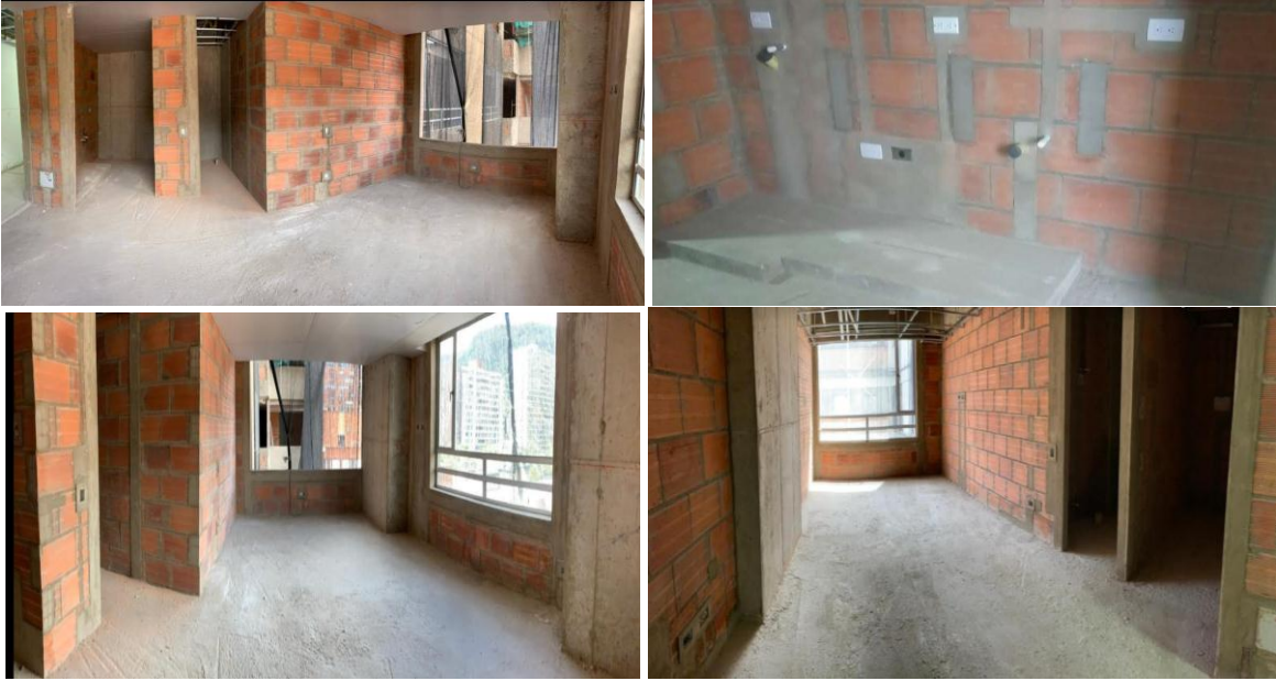
Figura 3. Se ve reflejado terminación mampostería, limpieza placas de entre piso, resanes obra gris para entrega de cada unidad inmobiliaria
