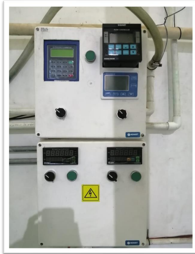
Figura 4. Tablero De Control Del Proceso
