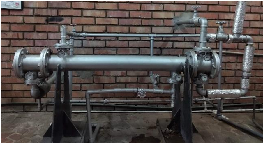
Figura 9. Banco de pruebas intercambiador de calor.
