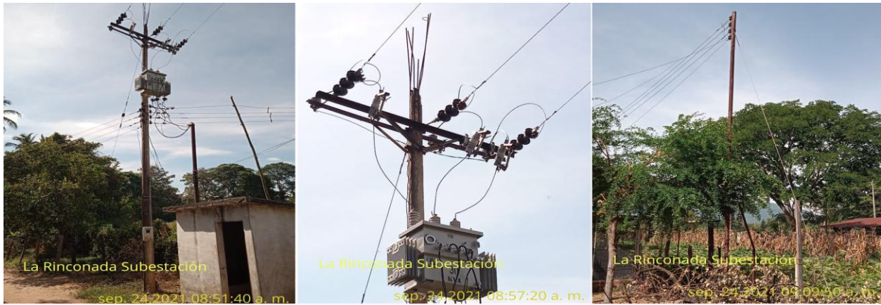
Figura 40. No cumplimiento de las distancias mínimas de seguridad e infraestructura en mal estado
