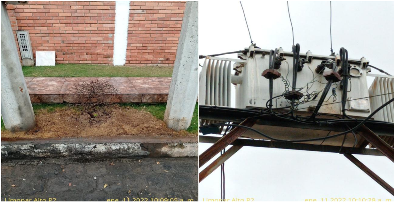
Figura 36. Daño causado del goteo de aceite del transformador a el medio ambiente
