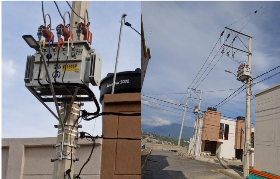
Figura 47. Transformadores con bornes aislados
