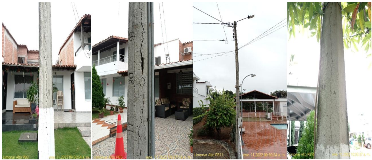
Figura 37. Postes en mal estado del condominio Limonar Alto
