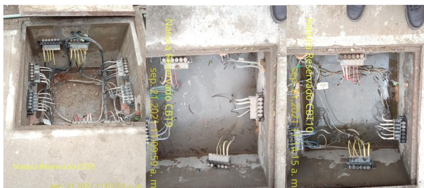
Figura 43. Evidencia de inundación de las cajas de baja tensión del conjunto Natura Reservado
