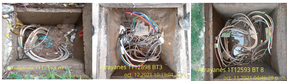
Figura 25. Estado de las cajas del conjunto los Arrayanes
