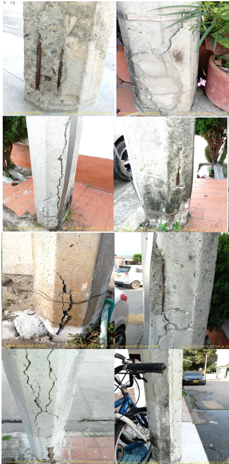
Figura 31. Infraestructura eléctrica en mal estado del conjunto Altos del Tamarindo
