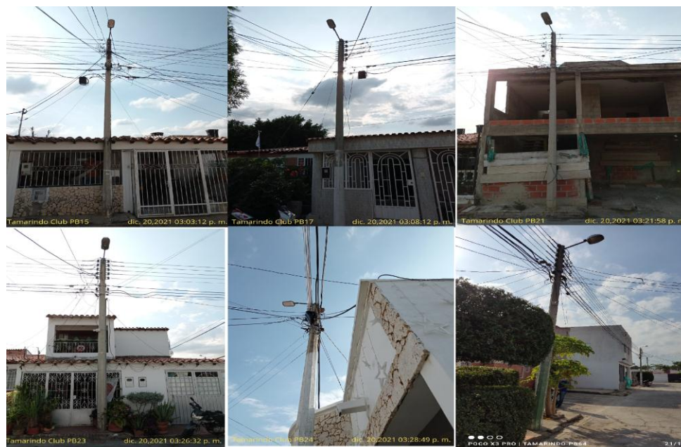
Figura 30. Incumplimiento de las distancias mínimas de seguridad del conjunto Altos del Tamarindo
