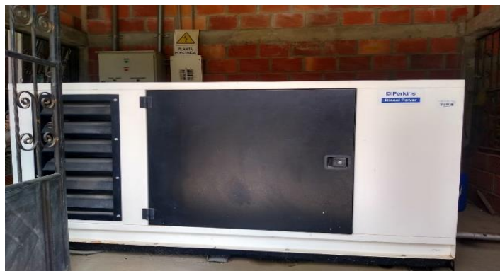
Figura 5. Planta eléctrica vista exterior
