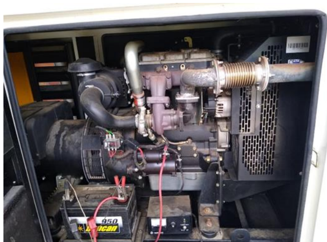
Figura 7. Planta electrica vista interior
