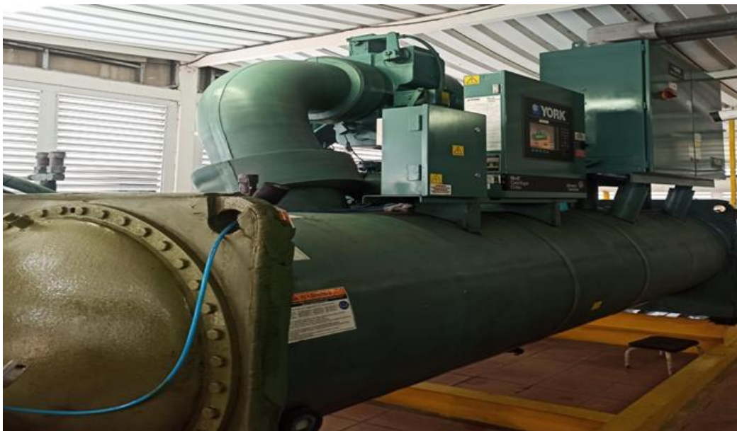
Figura 19. Chiller condensado por agua
