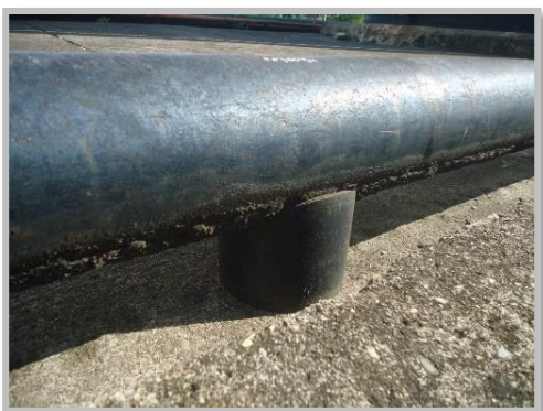
Foto 3. Soporte tubular sin aislamiento
