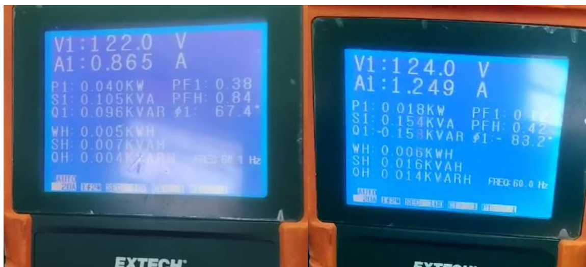
Figura 18. Medidas del analizador de potencia antes y después de la compensación de carga de 108 Var.
