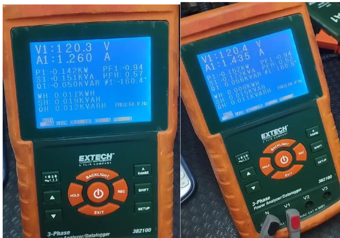
Figura 16. Medidas del analizador de potencia antes y después de la compensación de carga de 50 Var.
