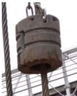
ILUSTRACIÓN 17. FINAL DE CARRERA QUE BLOQUEA LA SUBIDA DEL BLOQUE DE IZAJE Y LA EXTENSIÓN DEL BOOM (FOTO TOMADA POR EL ESTUDIANTE).
