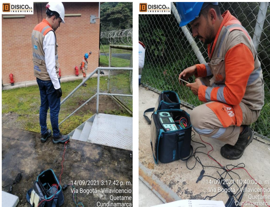
Figura 7. Medición de sistemas de Puesta tierra Fuente: Elaboración Propia
