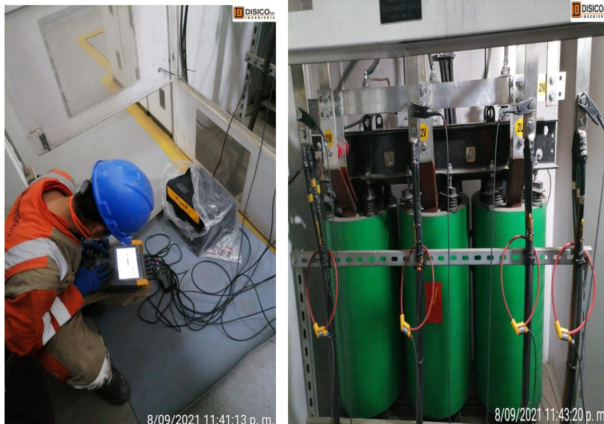
Figura 6. Mantenimiento de transformadores secos de media tensión Fuente: Elaboración Propia
