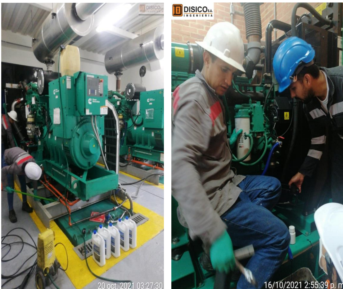
Figura 4. Mantenimiento de generadores Diesel Fuente: Elaboración Propia
