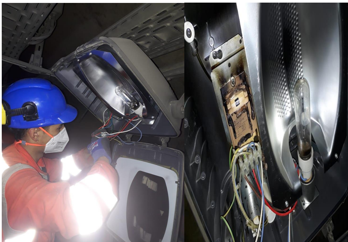
Figura 13. Mantenimiento de iluminación interior del túnel
