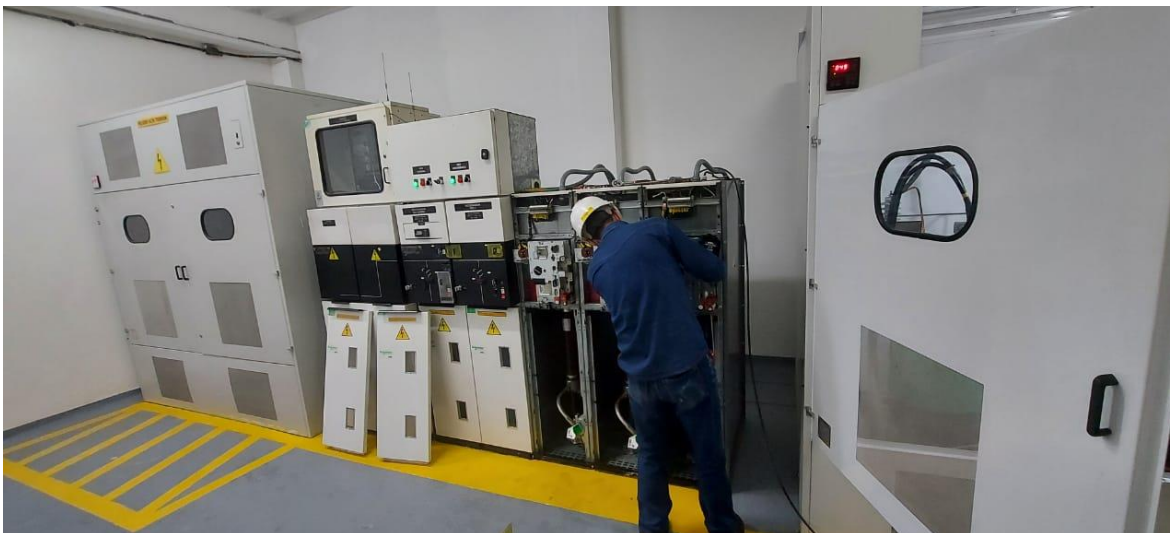
Figura 5. Análisis y Mantenimiento de celdas de media tensión Fuente: Elaboración Propia
