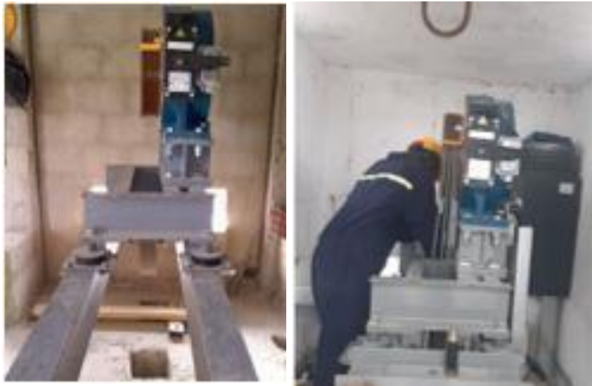
Figura 62. Instalación de cuarto de máquinas
