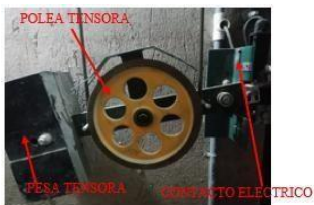
Figura 25. Limitador de velocidad
