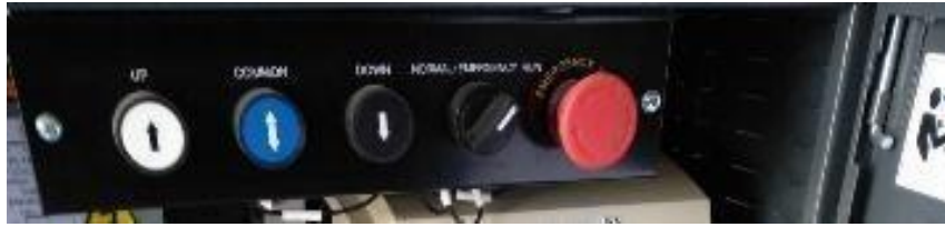
Figura 38. Caja de mantenimiento en cuadro de maniobra
