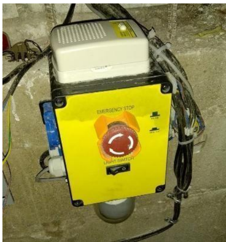
Figura 37. Caja de protección en el PIT
