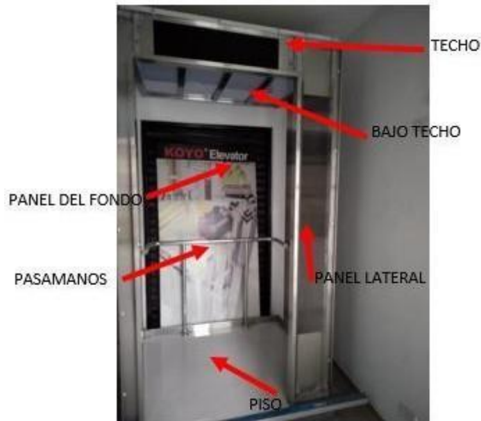
Figura 22. Cabina del ascensor
