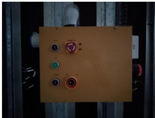
Figura 36. Caja o botonera de mantenimiento sobre cabina
