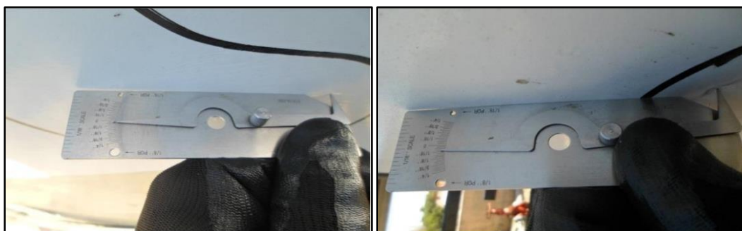
Fotografía 12. Medición en zona de pitting.
