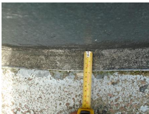
Fotografía 5. Estado de la pestaña perimetral del tanque.
