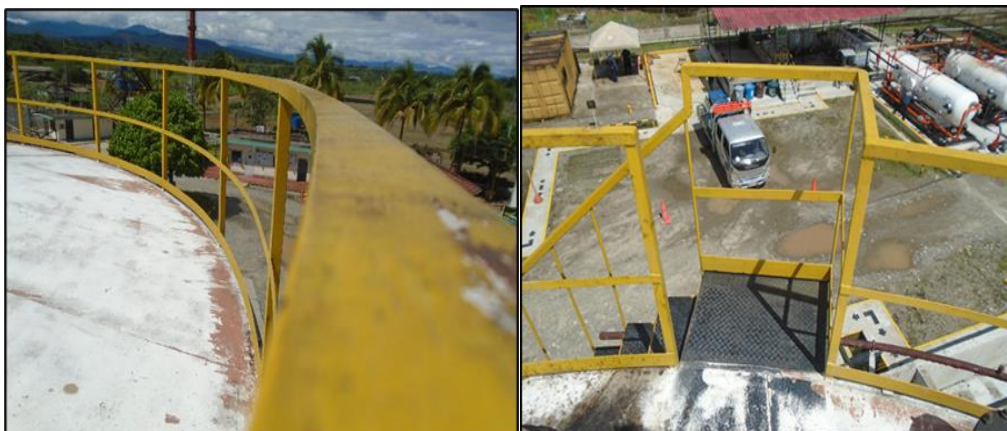
Fotografía 8. Plataforma escalera y Baranda perimetral, con recubrimiento en mal estado.
