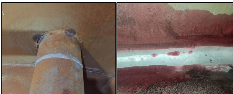
Fotografía 15. Pasante en la soldadura de respaldo de N5.
