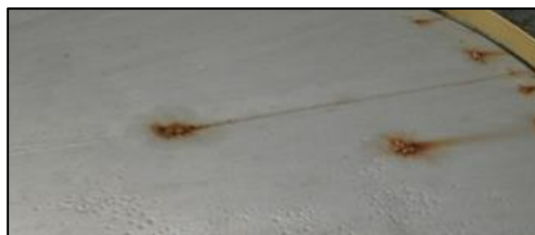
Fotografía 19. Zona de picaduras (lamina 3).
