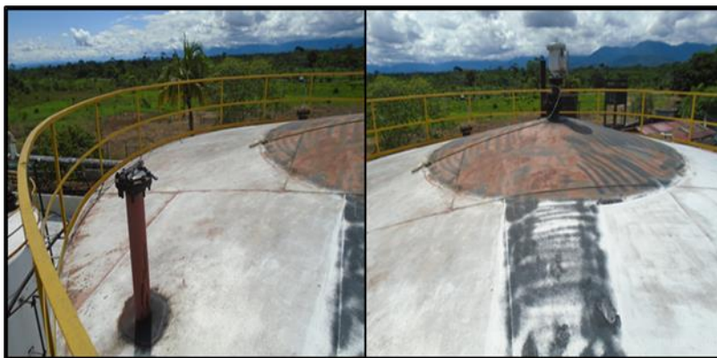
Fotografía 18. Estado del techo fijo.
