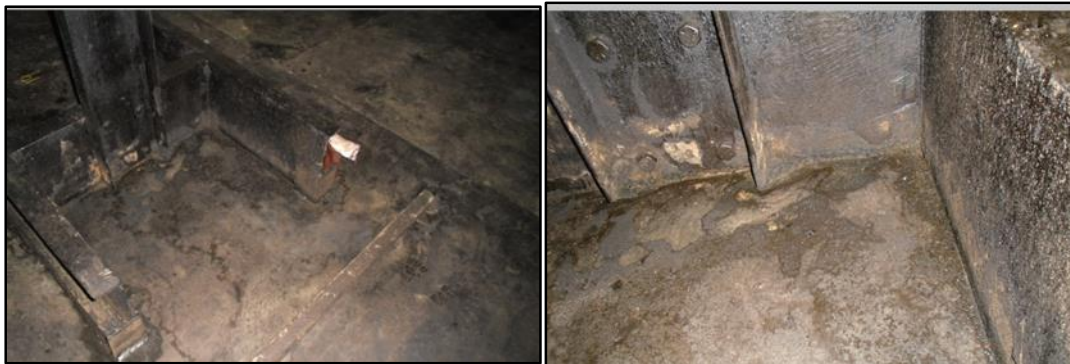
Fotografía 21. Estado de la columna central.
