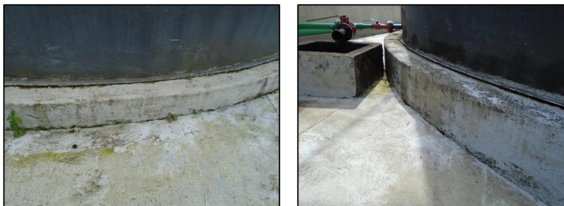
Fotografía 2. Estado de la fundación del tanque.
