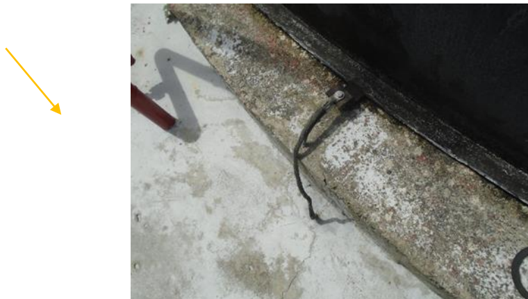
Fotografía 6. Conexión a tierra del tanque.
