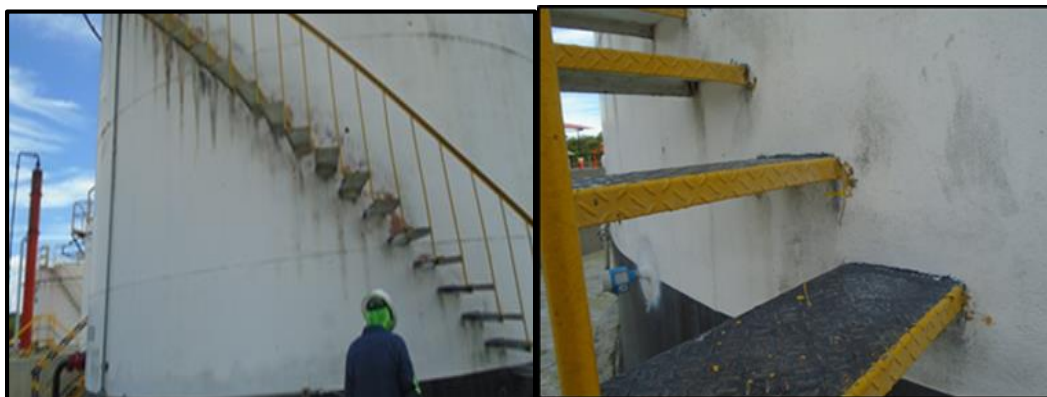
Fotografía 7. Estado de los elementos de las escaleras.
