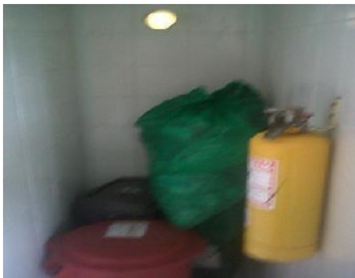
Figura 9. Fotografía Cuarto de almacenamiento. Fuente: Autor.
