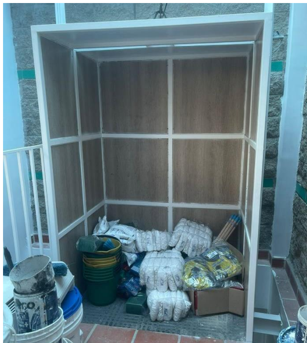
Figura 30. Foto del ascensor de carga
