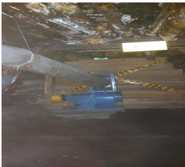
Figura 10. Ducto de ventilación acoplado
