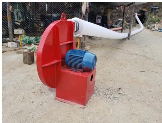
Figura 11. Ventilador Centrífugo mina el Silencio
