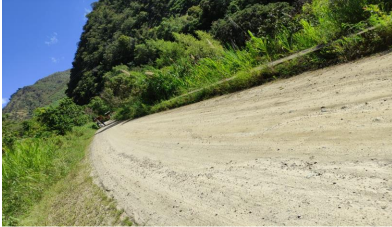
Figura 12. Vista tramo critico #3
