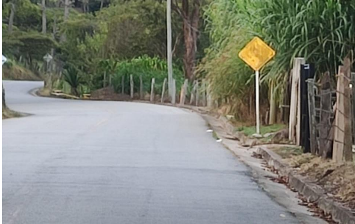
Figura 24. Estado de Señales Verticales.
