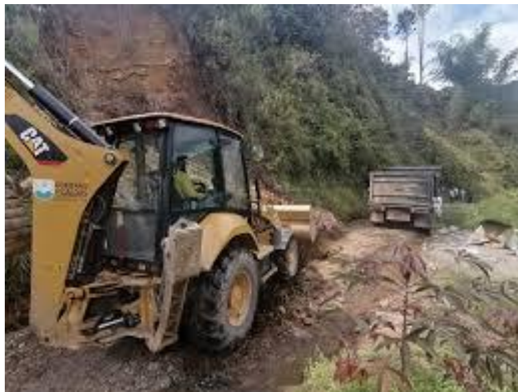
Figura 7. Presencia de desprendimiento de taludes.
