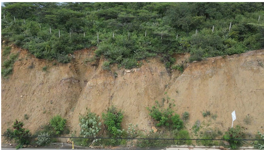
Figura 44. Tramo 1. Talud prolongación avenida 0
