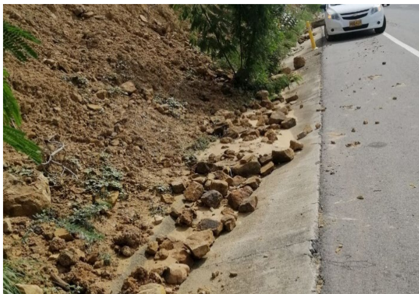
Figura 61. Obstrucción de cunetas - tramo 1
