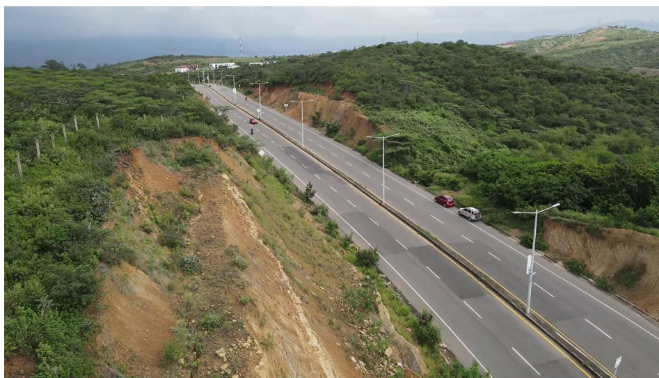
Figura 40. Tramo 1, Talud prolongación avenida 0
