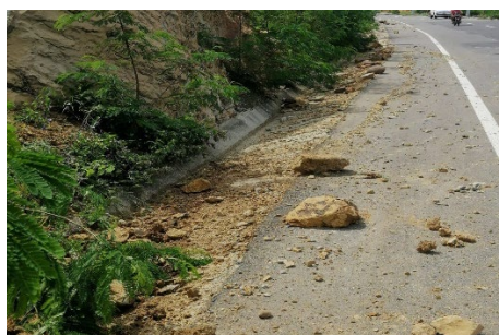
Figura 67. Obstrucción de la cuneta en el tramo 3
