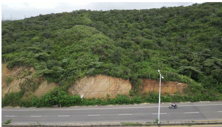
Figura 57. Tramo 4, Talud prolongación avenida 0
