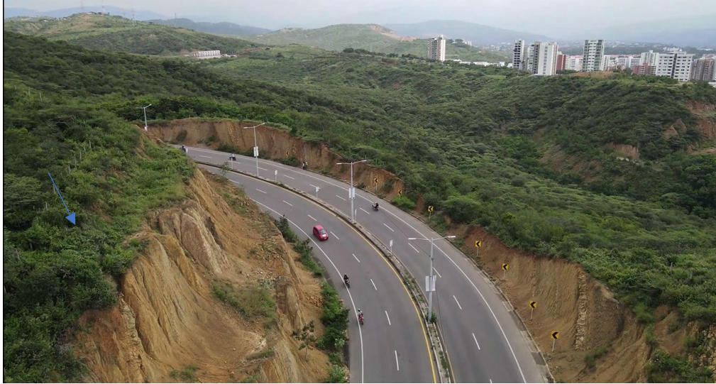
Figura 49. Tramo 2, Talud prolongación avenida 0
