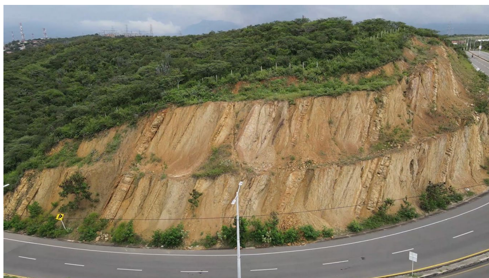
Figura 51. Tramo 3, Talud prolongación avenida 0
