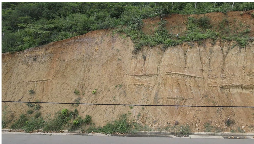
Figura 46. Tramo 1, Talud Prolongación Avenida 0
