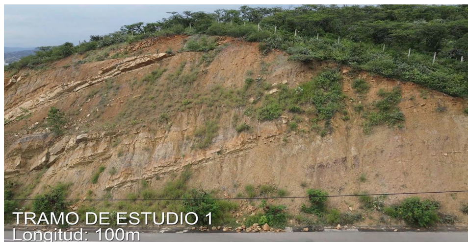
Figura 43. Tramo 1, Talud prolongación avenida 0
