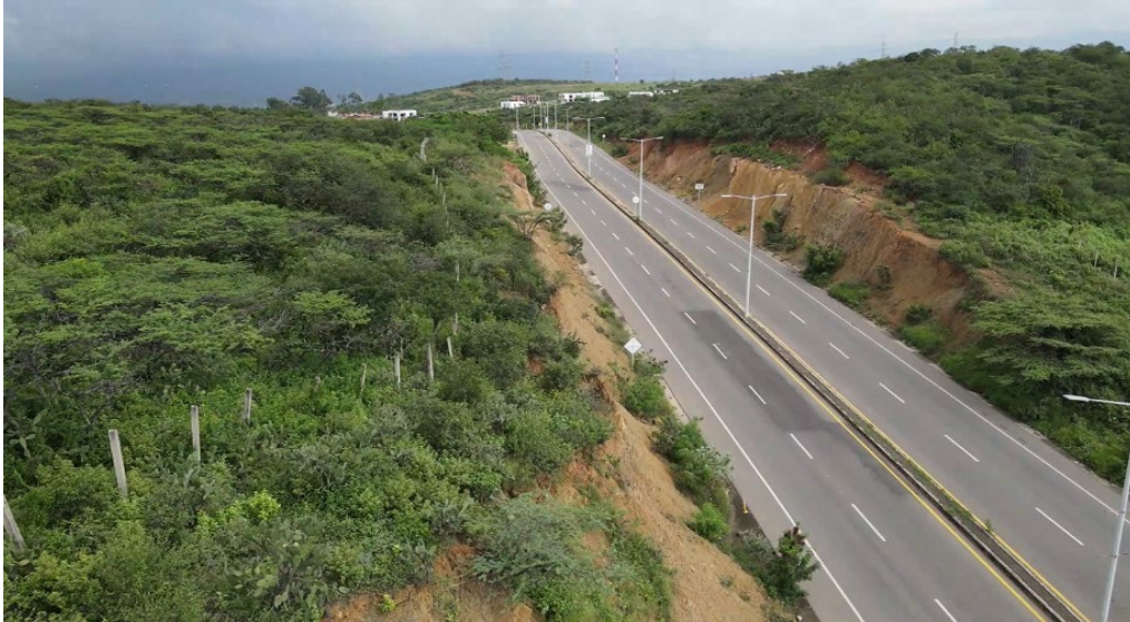
Figura 42. Tramo 1, Talud prolongación avenida 0
