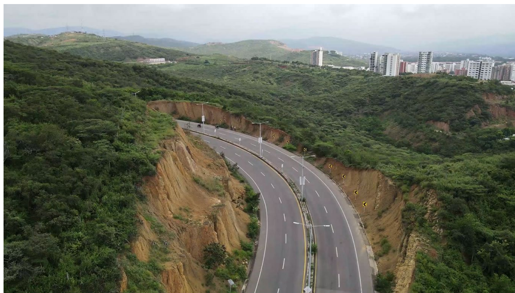
Figura 48. Tramo 2. Talud prolongación avenida 0
