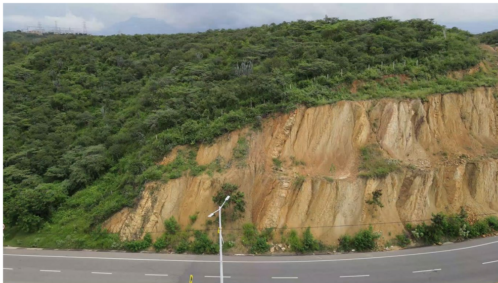
Figura 50. Tramo 3, Talud prolongación avenida 0
