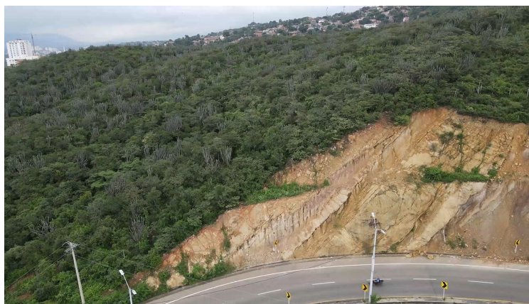
Figura 58. Tramo 5, Talud prolongación avenida 0
