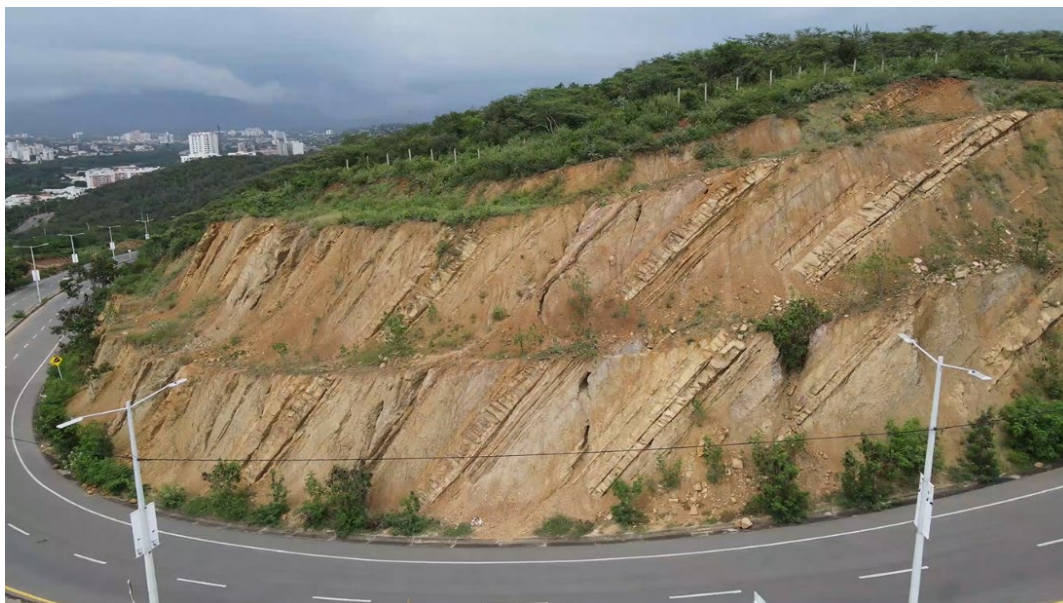
Figura 47. Tramo2, Talud prolongación avenida 0
