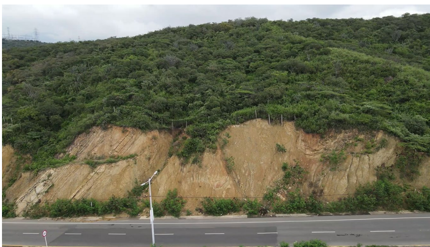
Figura 55. Tramo 4, Talud prolongación avenida 0
