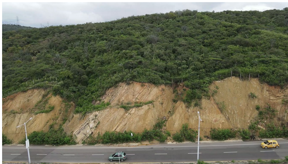
Figura 54. Tramo 4, Talud prolongación avenida 0
