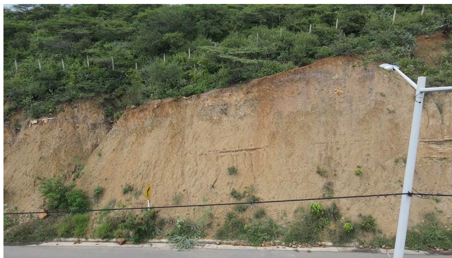
Figura 45. Tramo 1, Talud prolongación avenida 0
