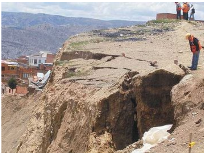
Figura 11. Grietas de tracción en corona de talud en la Paz, Bolivia. Fuente: Periódico La Razón, 2012
